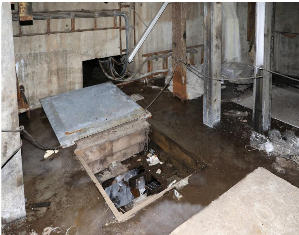
Figur 17. En av de 4 inspeksjonslukene på golvet over Hovedsjakt V (Østgruva) hvor sonden ble heist ned. Bildet er tatt ved en senere anledning og viser dannelse av is i selve åpningen til luka og på stålkonstruksjoner ved siden av åpningen. Dette er på grunn av at det stiger varmt damp fra det tempererte vannet i gruva.
